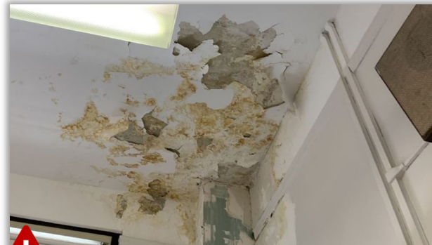
石膏/内部装修破损
