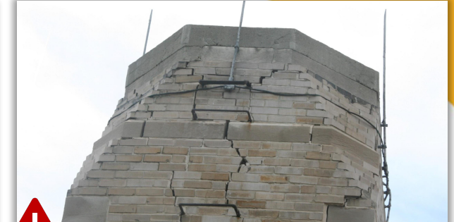
! Desplazamiento de la mampostería de la chimenea
