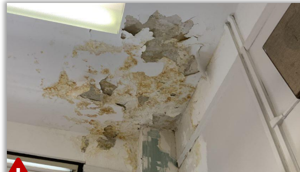
! Averías en estructuras de yeso/acabados interiores
