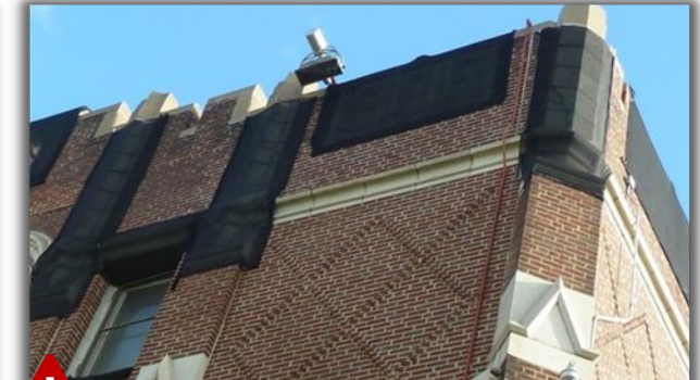
! Estabilización temporal de la erosión en ladrillos
