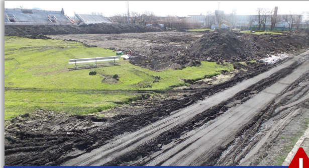
تباہ شدہ مصنوعی ٹرف اور ٹریک (حفاظتی خطرہ)
